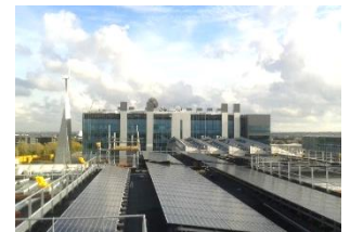
Sky Campus 1100m2 PV array
