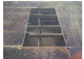
Grilles de drainage des terrains
